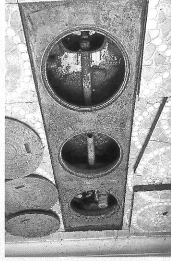
全てマンホールの上にタイルが貼られている
